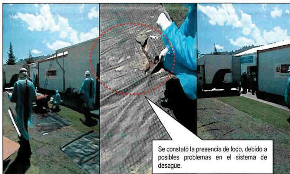
IMAGEN N° 12 NO CUENTA CON SISTEMA DE EVACUACION DE AGUAS PLUVIALES EN EL EXTERIOR
