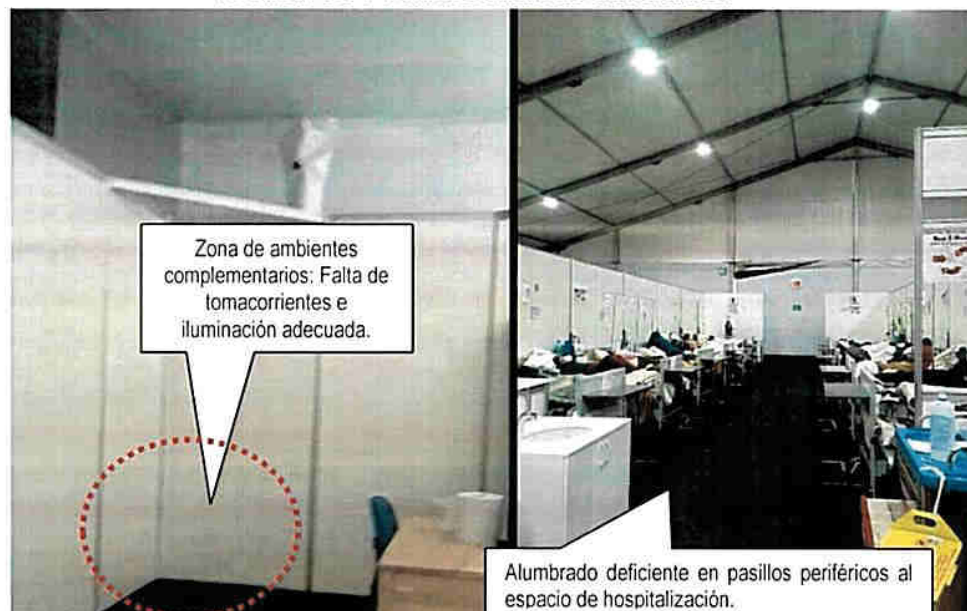
IMAGEN N° 7 ALUMBRADO Y TOMACORRIENTES DEFICIENTES
