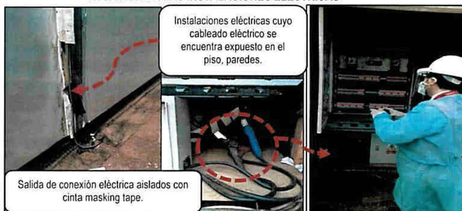
IMAGEN N° 5 SITUACIÓN DE LAS INSTALACIONES ELÉCTRICAS
