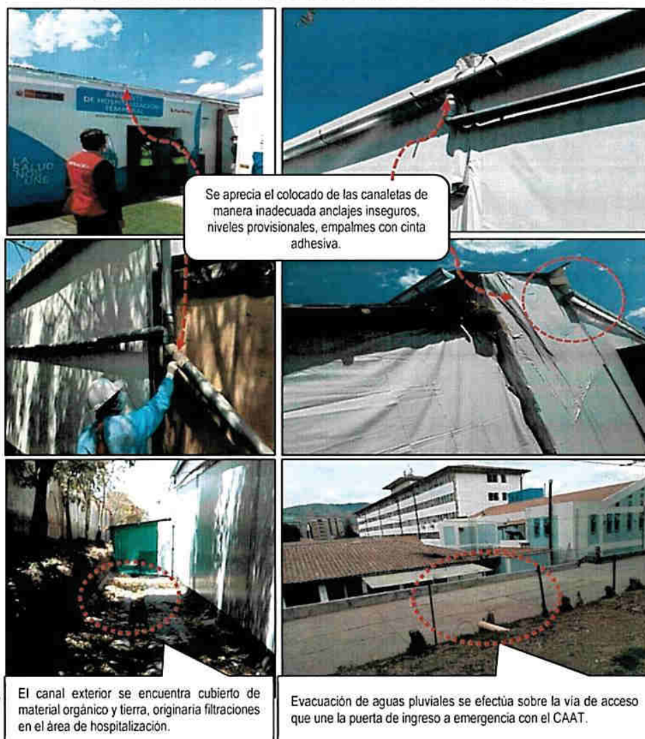
IMAGEN N° 11 CANALES DE EVACUACION DE AGUAS PLUVIALES EN MAL ESTADO
