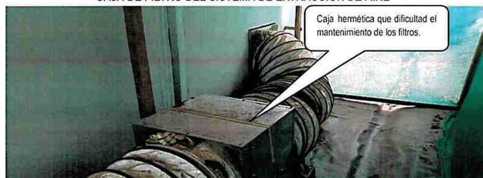
IMAGEN N° 10 CAJA DE FILTRO DEL SISTEMA DE EXTRACCIÓN DE AIRE
