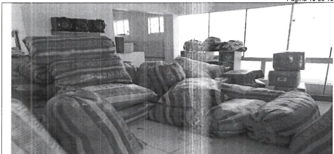
Foto 3. Las ventanas del Almacén no cuentan con protección de seguridad
