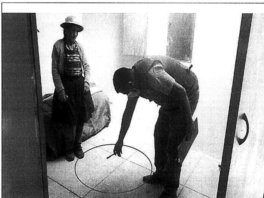
Imagen n.º 8: Muestra el desgaste prematuro de los pisos de cemento frotachado en el área multiusos
