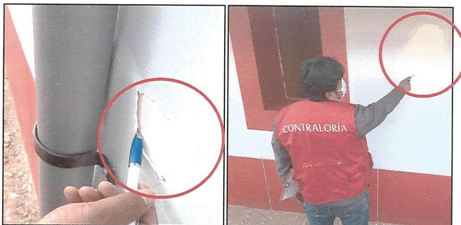
Fotografías n.ºs 5 y 6: Imágenes donde se advierte huecos y desprendimientos de enlucido en el exterior de los muros de adobe.
