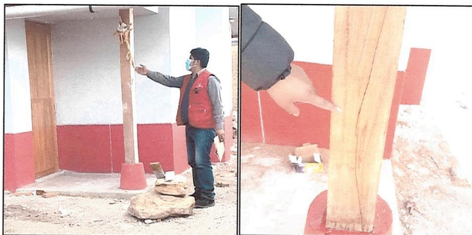
Fotografías n.ºs 3 y 4: Imágenes donde se advierte que la columna de madera de 2.8 metros y de sección 5"x5" presenta deformaciones, sin cepillado, ni protección con preservante, y roturas en las fibras de madera.
