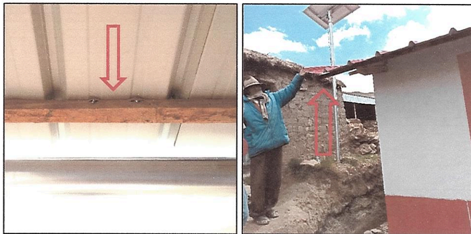
Fotografías n.º 13 y 14: Imágenes donde se advierte tirafones sin perpendicularidad con las planchas de aluzinc, y la cobertura sin una adecuada fijación.
