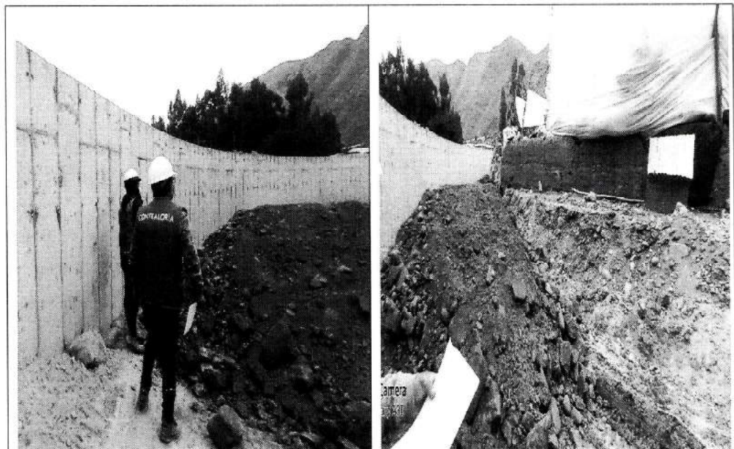
Imágenes n° 16 y n.° 17: Muestran la ejecución de la partida de Relleno y Compactado de Espaldón en la progresiva 4 + 360 del Sector II, en la cual se puede evidenciar que el material utilizado no es seleccionado, incumpliendo lo indicado en el Expediente Técnico.
