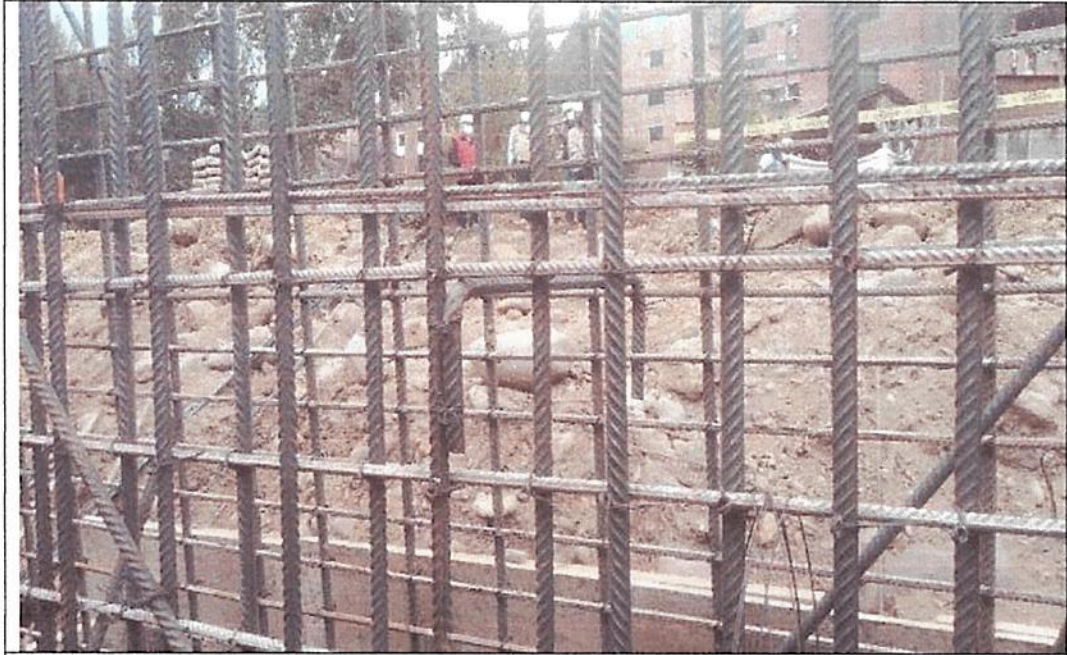
Las fotografías n° 33, n° 34, n° 35, muestran refuerzos con alturas variables que no coinciden con lo indicado en los planos, así como corrosión de en el acero transversal de muro de pantalla.
