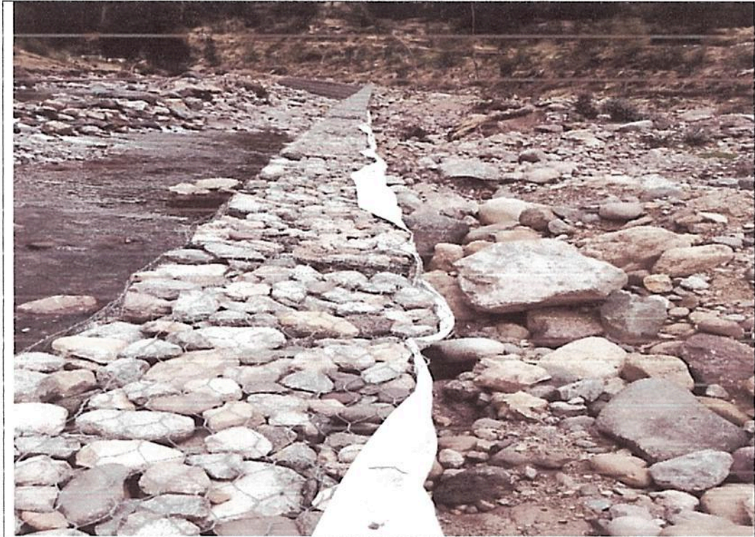
Las fotografías n° 36, n° 37, muestran material excedente en las orillas del río producto de la ejecución de partidas de corte sumergida en marjal suelto y roca suelta.
