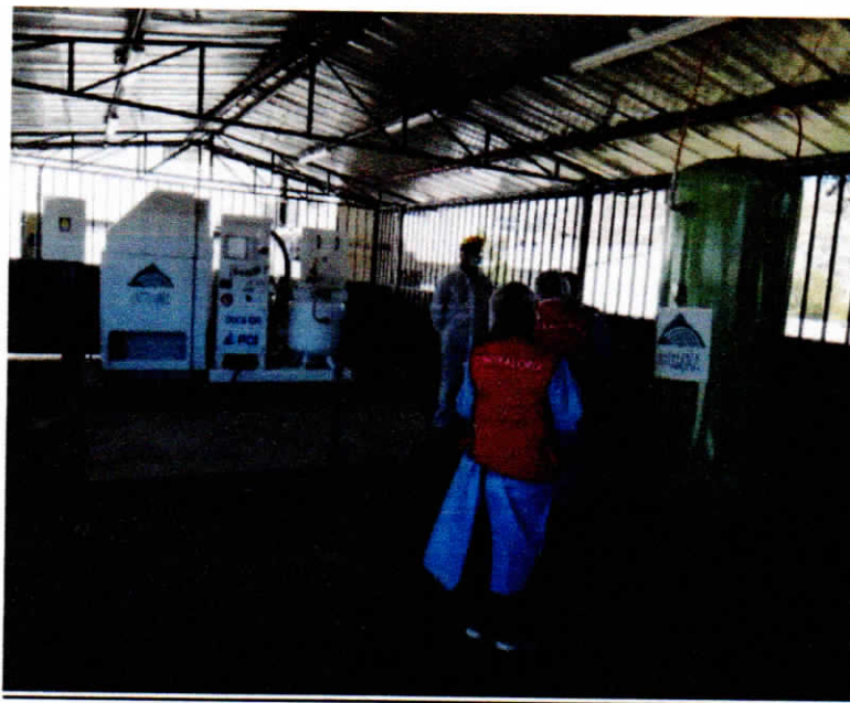
IMAGEN N° 1 MAQUINARIA GENERADORA DE OXIGENO GASEOSO MEDICINAL Y TANQUE DE OXIGENO DONADO POR LA EMPRESA ANTAMINA SA
