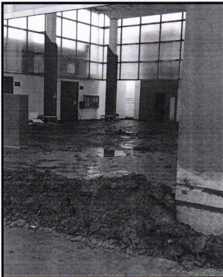
IMAGEN N° 3 PABELLÓN DE MULTIUSOS Y COCINA, EN SU TOTALIDAD RELLENO DE LODO
