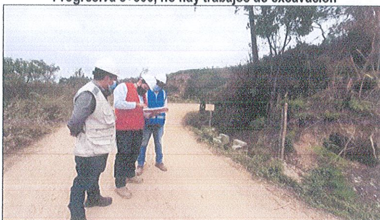
Imagen n.º 1 Progresiva 8+300, no hay trabajos de excavación
