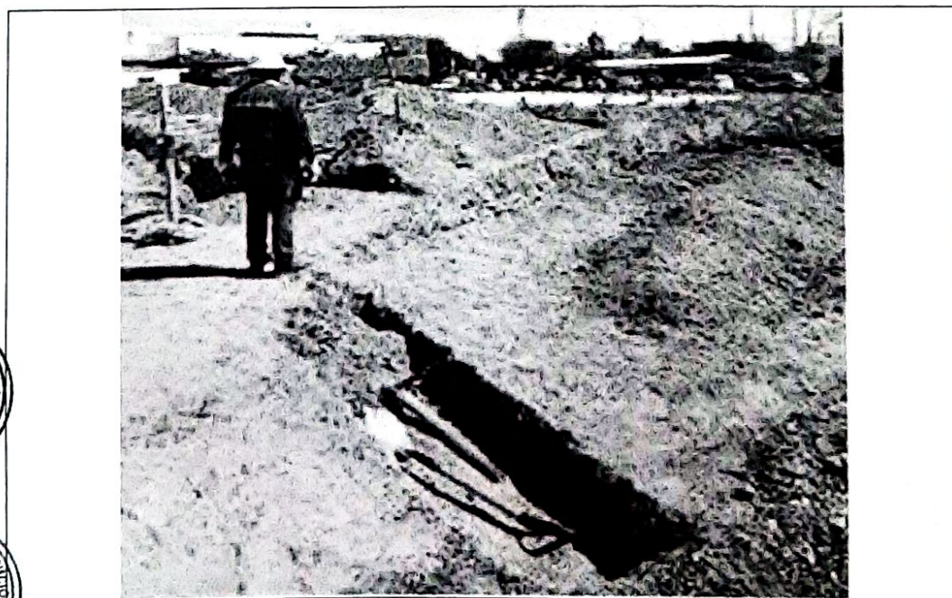
Imagen N° 6 FALTA DE SEÑALIZACIÓN EN EXCAVACIONES
