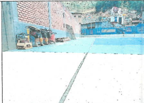
Fotografía n.º 46: Se ve en la imagen planchas compactadoras y apisonadoras en la intemperie, expuestas a factores climáticos.
