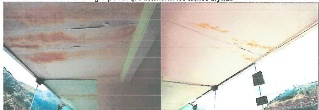
Fotografía n.º 27 y 28: Filtraciones de aguas pluviales que vienen deteriorando los acabados y pinturas del techo drywall de las cabinas de radio y tv.
