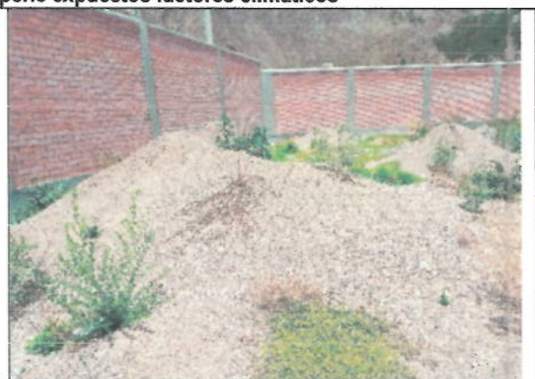
Fotografía n.º 42: Se ve agregado y arena gruesa, notar el crecimiento de vegetación por falta de resguardo y cuidado
