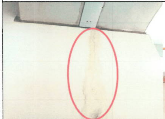
Fotografía n.º7: Se aprecia: filtraciones de aguas pluviales que transcurren por las juntas metálicas, afectando las paredes y muros en ambientes inferiores de la tribuna.
