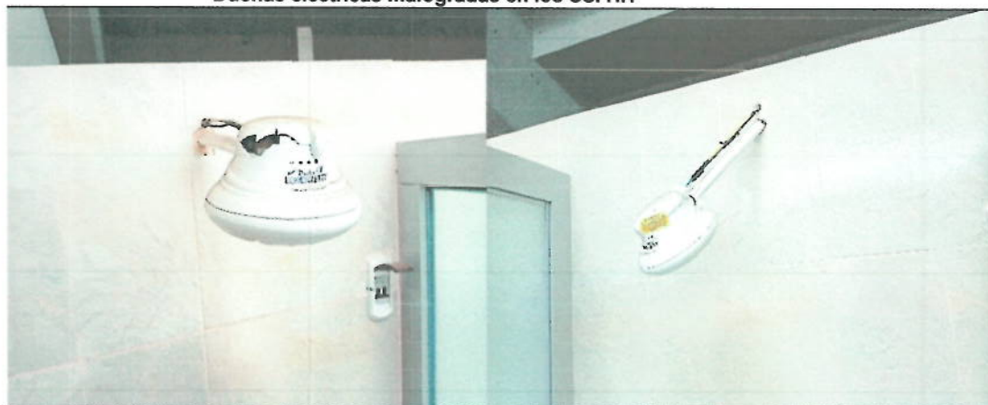
Fotografía n.º 31 y 32: Duchas eléctricas malogradas en los SS.HH. de los ambientes camerinos de la tribuna del estadio.
