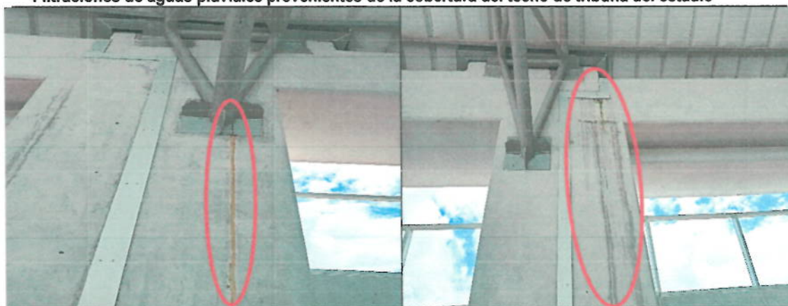
Fotografía n.º1: Se aprecia: filtración de aguas pluviales con presencia de óxido que desciende por las estructuras metálicas y columna.
