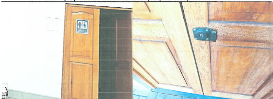
Fotografía n.º 33 y 34: Puertas que presentan defecto en las chapas (no cierran), en los SS.HH de varones y mujeres de la tribuna este del estadio
