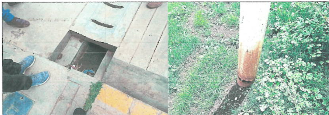
Fotografía n.° 37: Falta tapar las cunetas del drenaje pluvial en la calle Pasaje Angamos en los exteriores del estadio IPD.
