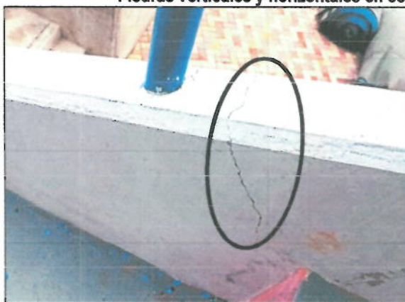
Fotografía n.º11: Se evidenció la existencia de fisuras verticales en el muro de la baranda derecha de la gradería, en la tribuna del lado este del estadio.
