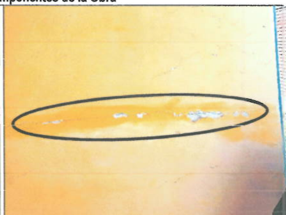
Fotografía n.º12: Se encontró fisuras horizontales en la mitad del muro diagonal de concreto ubicado al lado de la escalera en las cabinas de radio y tv del estadio.
