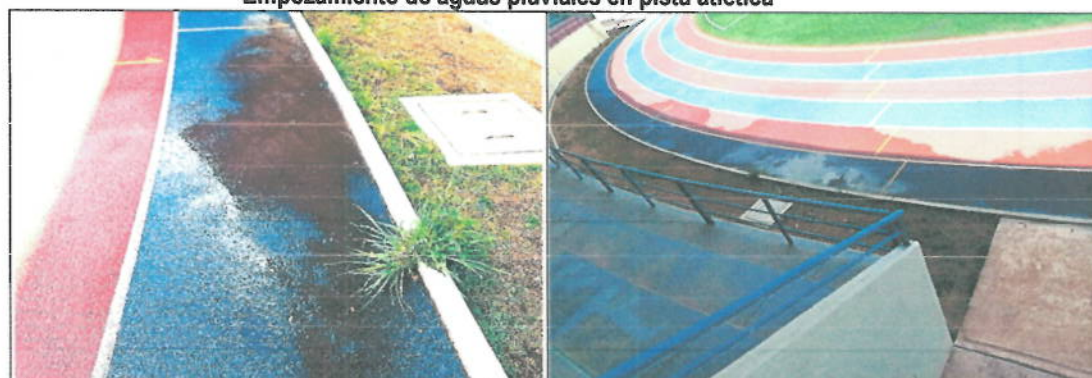
Fotografía n.° 39 y 40: Empozamiento de aguas pluviales en pista atlética del estadio.
