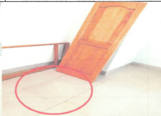
Fotografía n.º8: Se aprecia: emposamiento de agua pluvial en uno de los ambientes inferiores de la tribuna.
