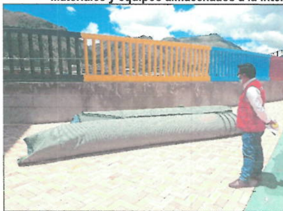
Fotografía n.º 41: Se ve rollos de gras sintético, tendido en el suelo sin ningún tipo de protección.
