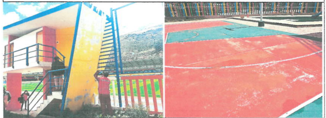
Fotografía n.º 21: Deterioro y desprendimiento de capas de pintura en muros de concreto en las cabinas de radio y TV del estadio.
