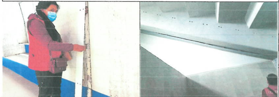
Fotografía n.º 25: En la gradería de la tribuna principal del estadio, se evidenció el desprendimiento y deterioro temprano las juntas estructurales de aluminio.
