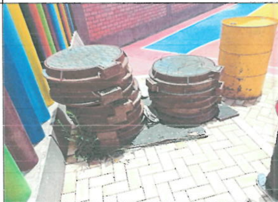
Fotografía n.º 50: En la imagen se observa buzones, los cuales se encuentran oxidados, no siendo adecuado su uso
