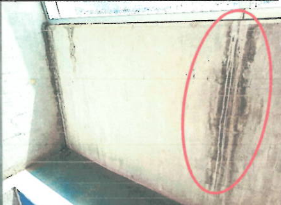
Fotografía n.º6: Se aprecia: humedad y filtraciones de aguas pluviales en los muros de tribuna.
