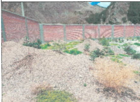
Fotografía n.º 49: En la imagen se observa agregados con crecimiento de vegetación, la cual no es la adecuada para su uso en trabajos de construcción.
