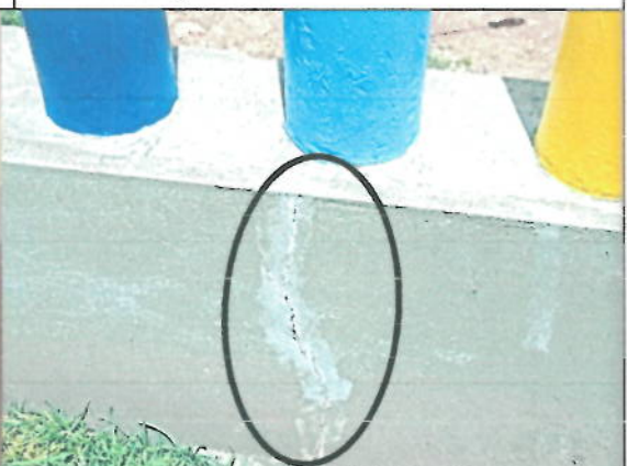
Fotografía n.º14: Se halló fisuras verticales en la parte superior del muro de contención (corona) ubicada en la parte posterior del campo de básquet del estadio.
