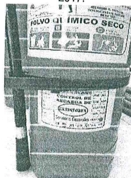
Imagen n.º 19 Carga de extintor vencido en noviembre de 2017.
