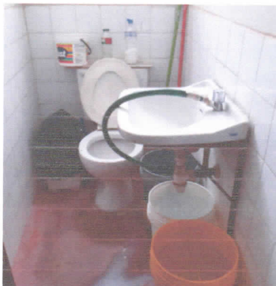
Imagen n.º 3 Punto de lavado no permite el libre uso de los caños
