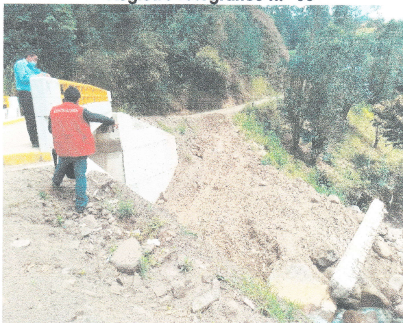
Márgenes del río con material excedente del relleno y con restos de puente demolido.
