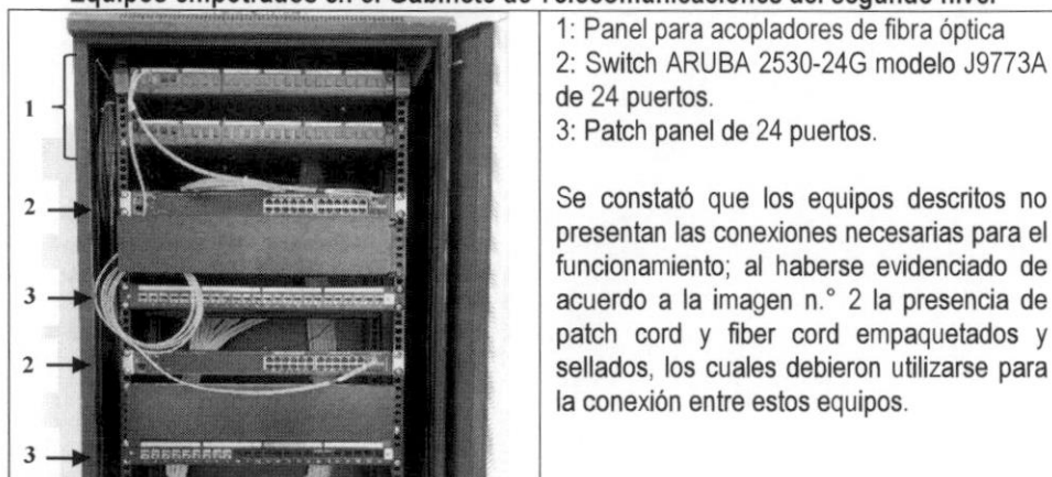
Cuadro n.º 7 Equipos empotrados en el Gabinete de Telecomunicaciones del segundo nivel
