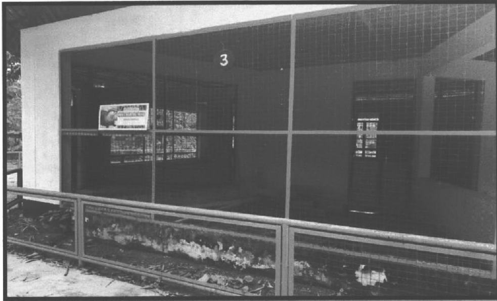
Imagen n.º 7 Jaulas vacías y en mal estado
