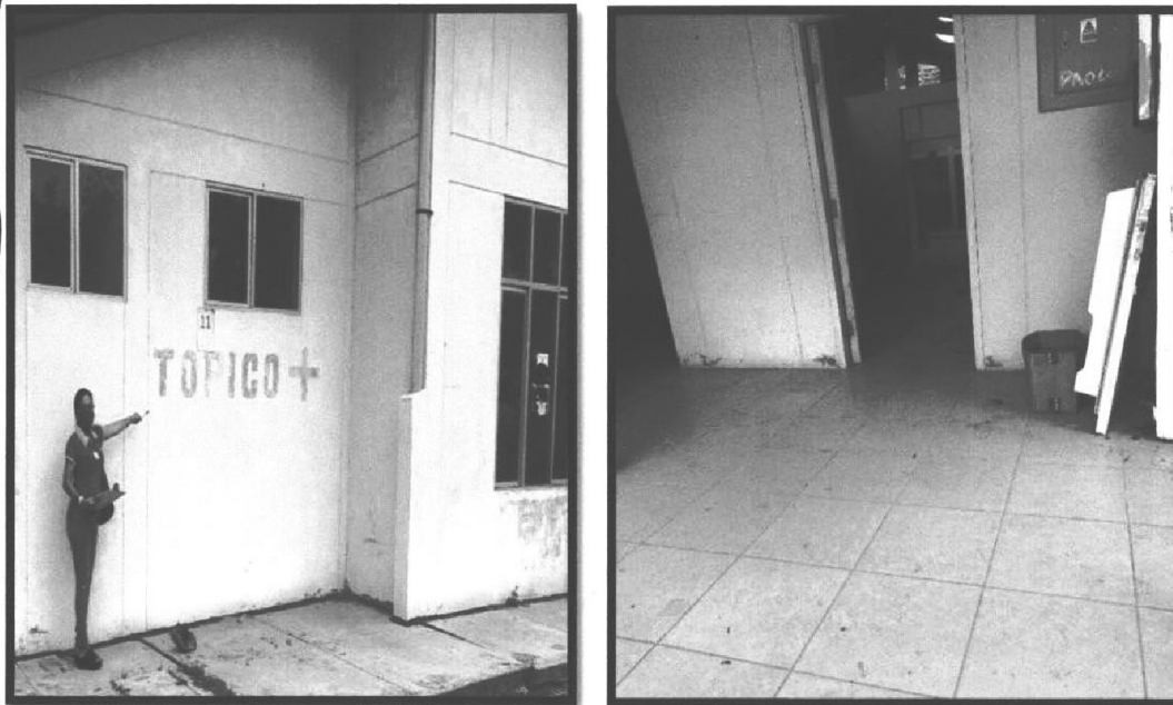
Imagen n.º 12 y 13 Tópico inoperativo por falta de infraestructura adecuada, equipos e insumos
