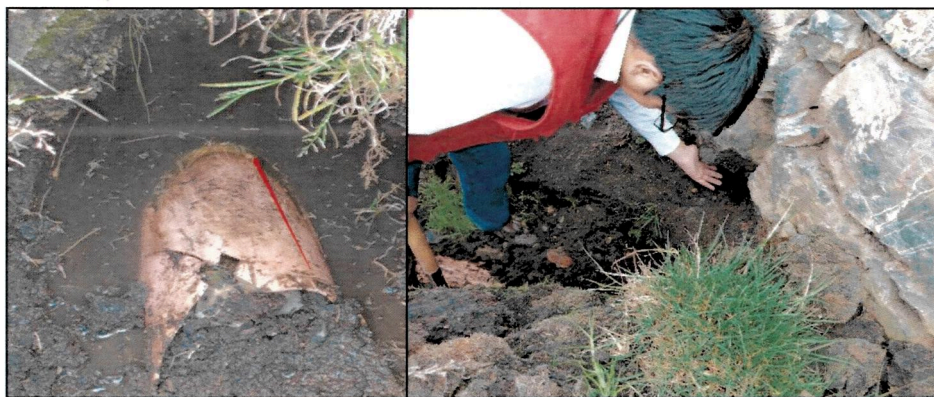
Gráfico n.º 34 Inexistencia de cimiento del muro de contención
