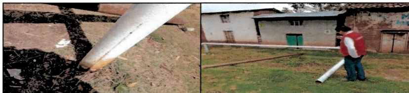
Gráfico n.º 31 Arcos del campo deportivo en estado de corrosión
