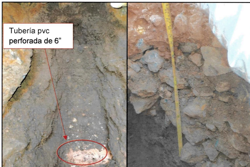
Gráfico n.º 5 Tubería perforada del buzón n.º 6
