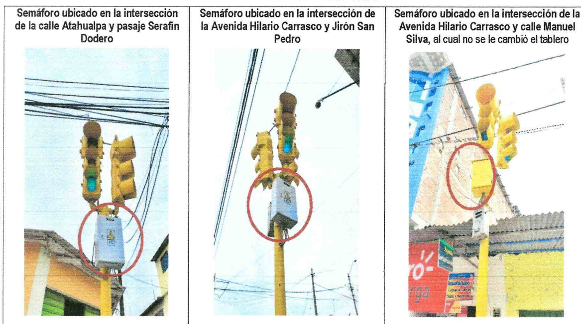
IMÁGENES N.ºS 3, 4 y 5 TABLEROS DE CONTROL DE LOS SEMÁFOROS
