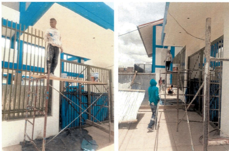
Fotografía N°s 13 y 14: Imágenes de la zona del acceso principal, donde se evidencia que personal del contratista labora sin los equipos de protección individual (EPI).
