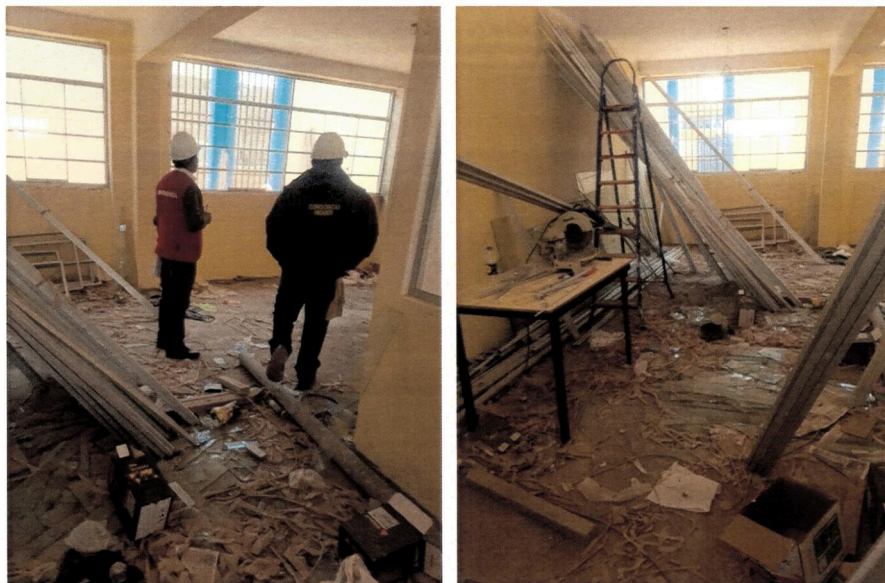
Fotografía N° 10 y 11: Imágenes del primer nivel de la zona del bloque N° 5, primer nivel se aprecia desorden y falta de limpieza que en el ambiente instalado como taller temporal que impide el tránsito y trabajo normal del personal que labora en la misma.
