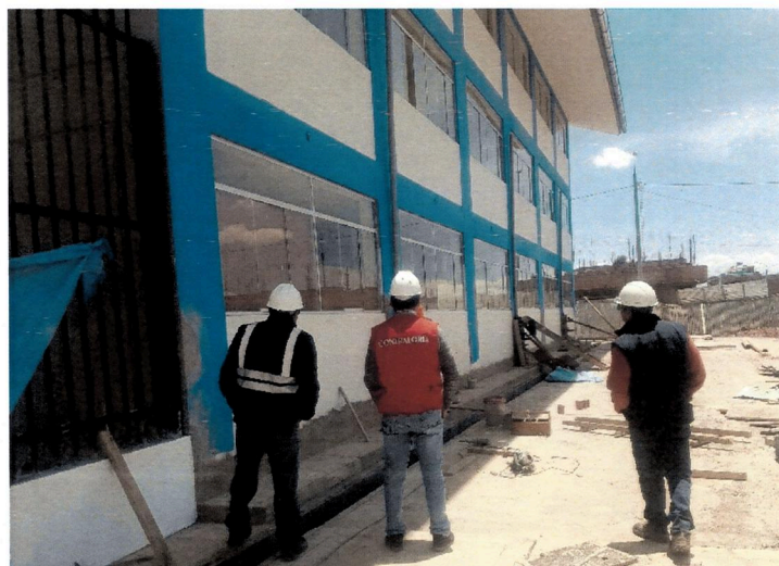
Fotografía N° 1: Exteriores de la Zona del Módulo 2 (Bloque II), se aprecia la falta de seguridad para los ambientes de gestión administrativa y pedagógica de la Institución Educativa
