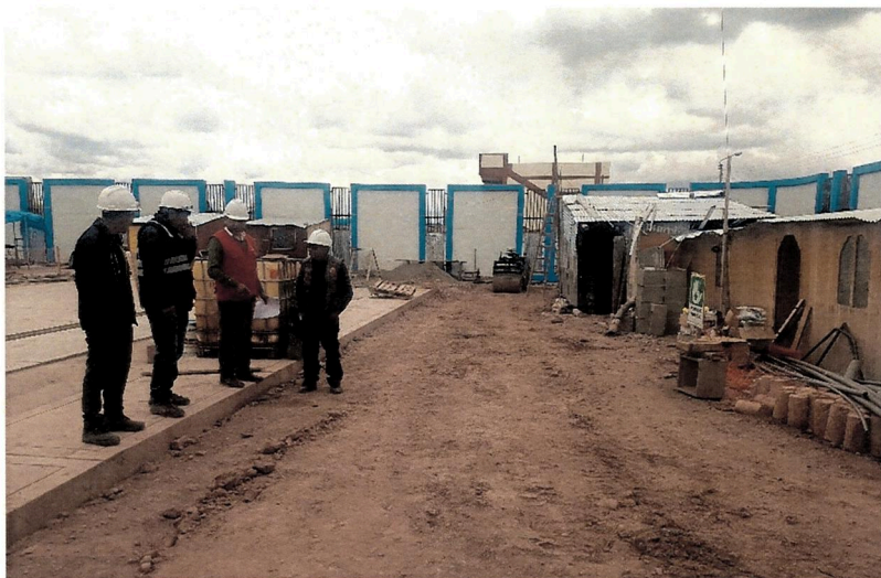
Fotografía N° 3: Imagen donde se aprecia que no se ha ejecutado trabajos de cimentación para estructura de soporte de la Malla Rashell.
