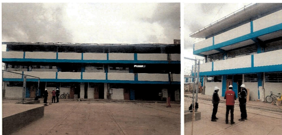
Fotografía N° 4 y 5: Imagen donde se aprecia la falta de ejecución de montantes de 3" para sistema de aguas pluviales del bloque N° 5.
