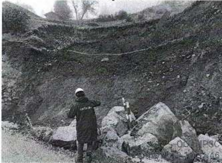
Deficiente señalización de la zona de riesgo por deslizamiento de talud.
