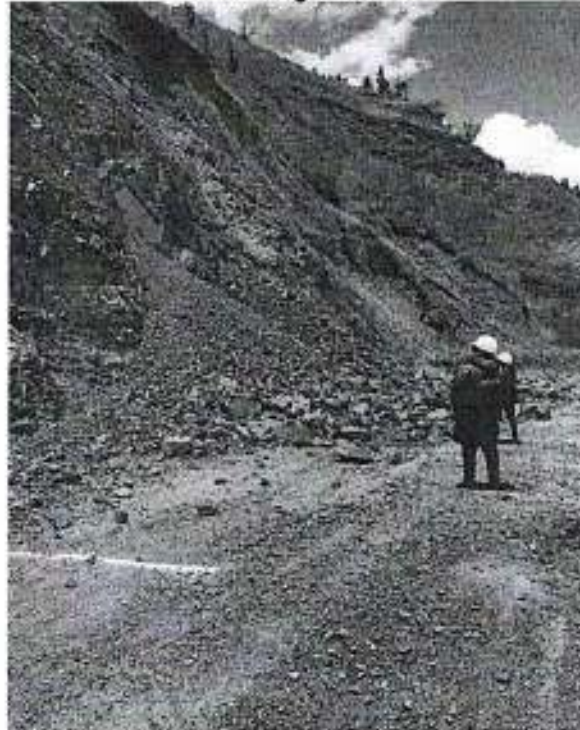
Zona de riesgo por deslizamiento de rocas, a la altura de la progresiva km. 11+600 aproximadamente.
