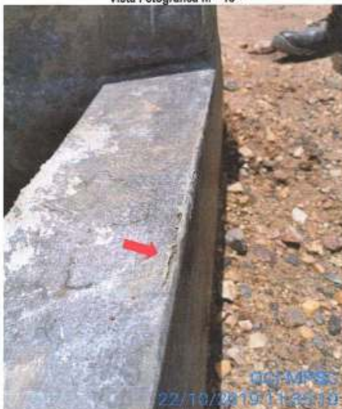
Tarrajeo de la caja de inspección de salida presenta fisuras y piel de cocodrilo.
