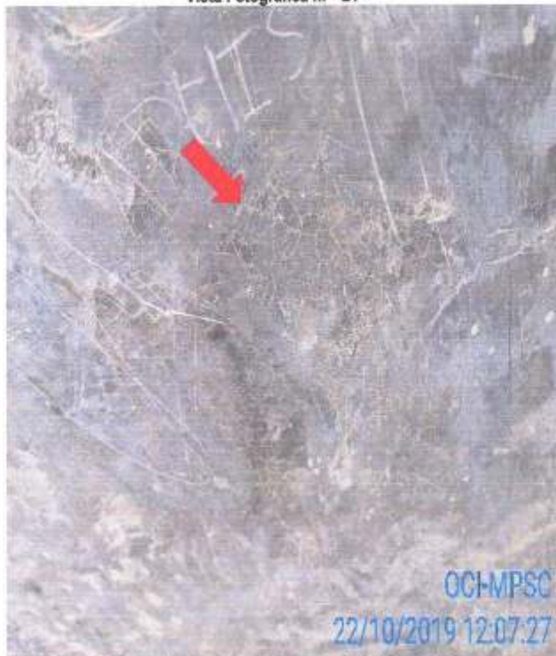
Tarrajeo de caja de inspección presenta piel de cocodrilo.
