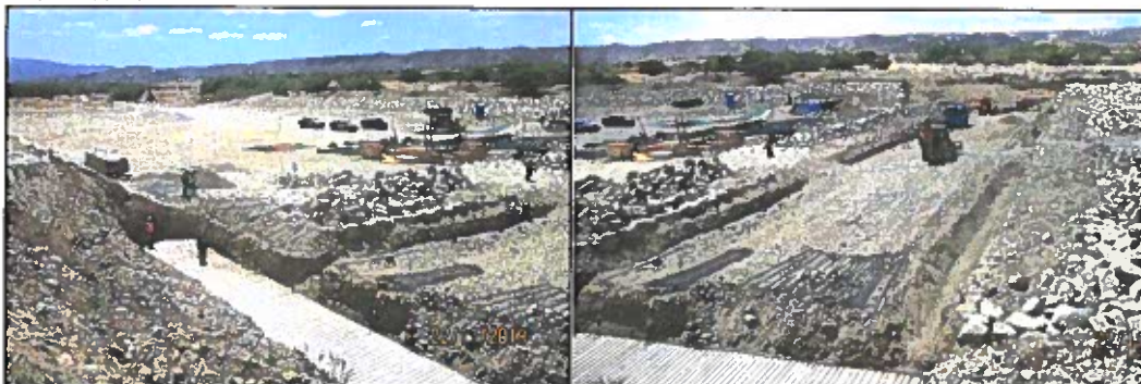
Fotografías n.° 2 y 3: Se aprecia la conformación de la base de la zapata (solado) del muro de protección; asimismo se observa la conformación de zanjas para las uñas del barraje. Y, enrocado propiamente dicho.
