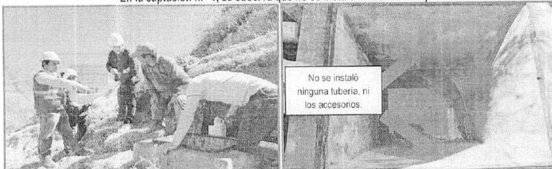
Imagen n.ºs 22 y 23 En la captación n.º 1, se observa que no se instaló la válvula compuerta de 1"
