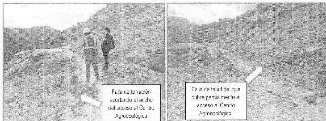
Imagen n.º 14 y 15 Vista del acceso principal al Centro agroecológico colapsado debido al desprendimiento del terraplén y falla del talud.
