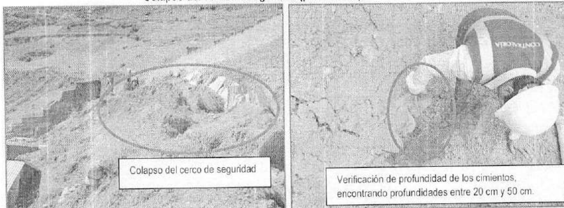
Imagen n.° 17 y 18 Colapso del cerco de seguridad (perimétrico)
