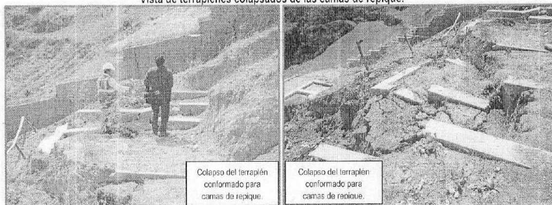
Imagen n.º 2 y 3 Vista de terraplenes colapsados de las camas de repique.
