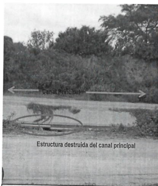
Leyenda: Vista de tramo destruido del canal
