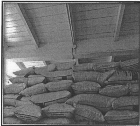
Techo de madera del primer y segundo ambiente no reviste la seguridad necesaria
