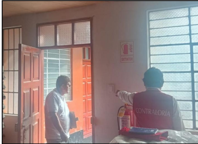
Imagen n.º 12 Interruptor de luz sin fluido eléctrico en el almacén de bienes de ayuda humanitaria
