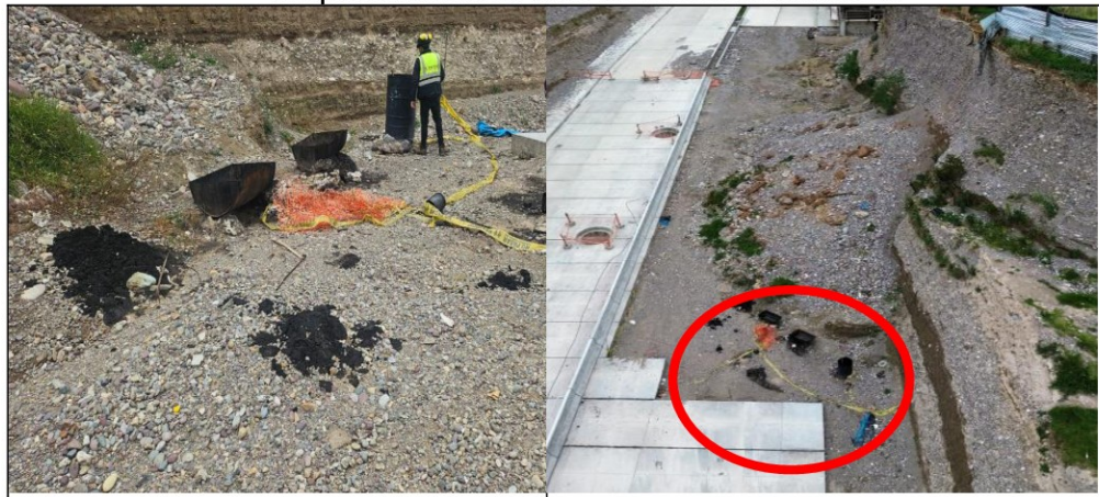
Panel fotográfico n.º 2 Recipientes de asfalto cerca del deslizamiento de talud
