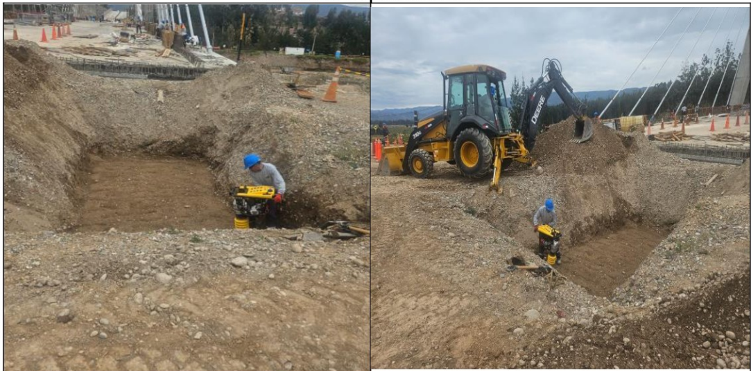
Panel fotográfico n.º 5 Falta de acceso para el desnivel
