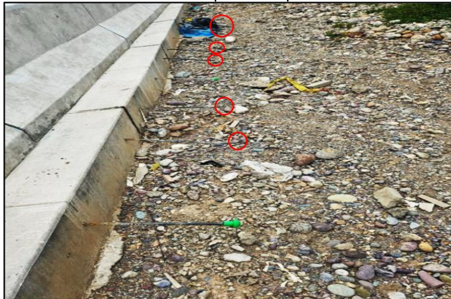
Fotografía n.º 3 Fierros sin capuchones de protección
