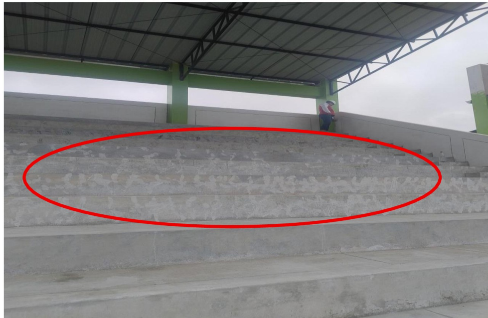
Fuente: Inspección física de 8 de setiembre de 2025.
