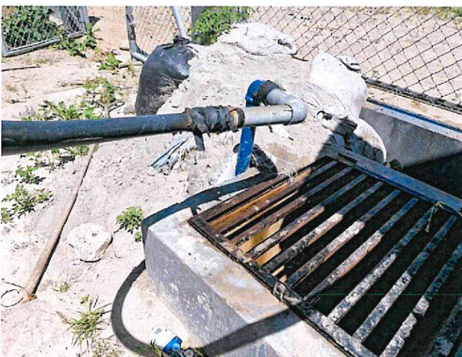
Fotografía n.º5.- Se visualiza la caja de rebose y limpia.
