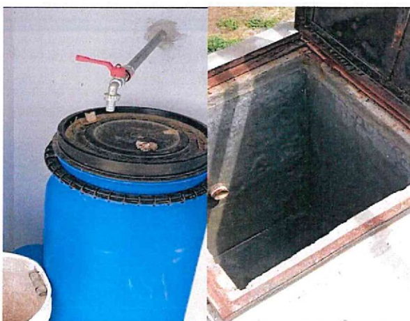
Fotografía n.º12.- Sistema de cloración / Reservorio del tanque elevado se encuentra sin agua.
