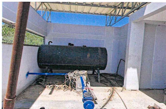
Fotografía n.º8.- Vista de tanque de combustible del grupo electrógeno y tuberías de impulsión.
