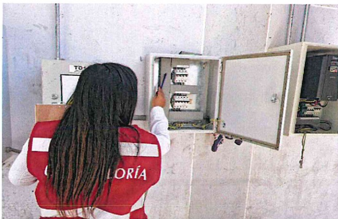
Fotografía n.º7.- Tablero de distribución de energía eléctrica, de la caseta de pozo tubular, se encuentra sin leyenda.
