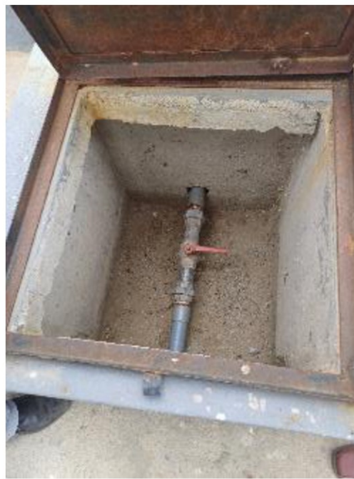
Fotografía N°04: Válvula de control
