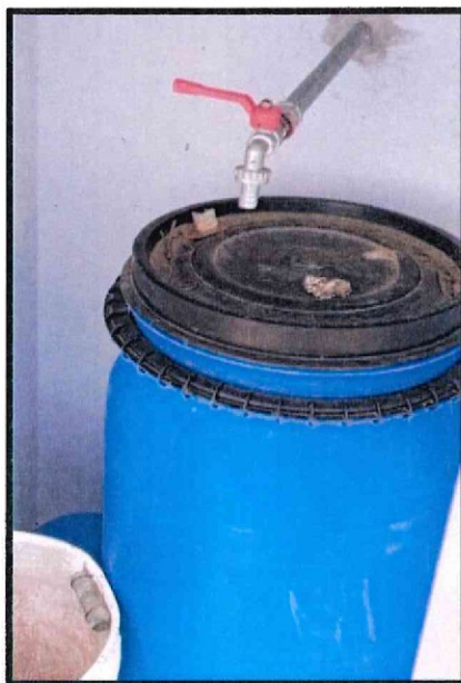
Imagen n.º 4 Equipamiento del sistema de cloración en tanque elevado
