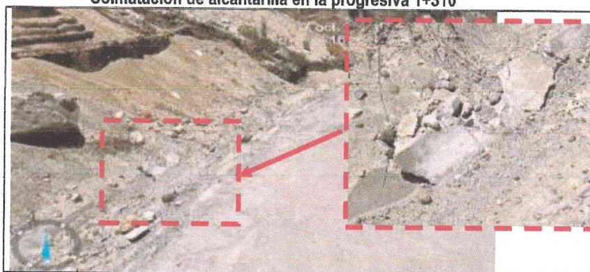
Imagen n.º 10 Colmatación de alcantarilla en la progresiva 1+310
