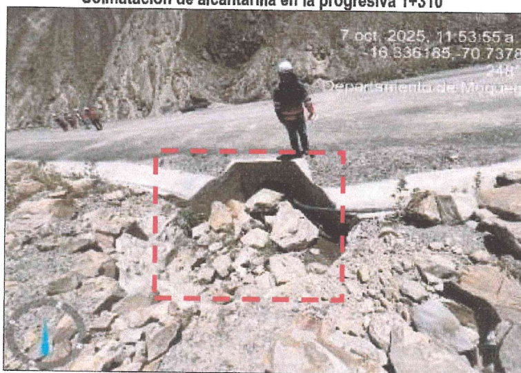
Imagen n.º 11 Colmatación de alcantarilla en la progresiva 1+310
