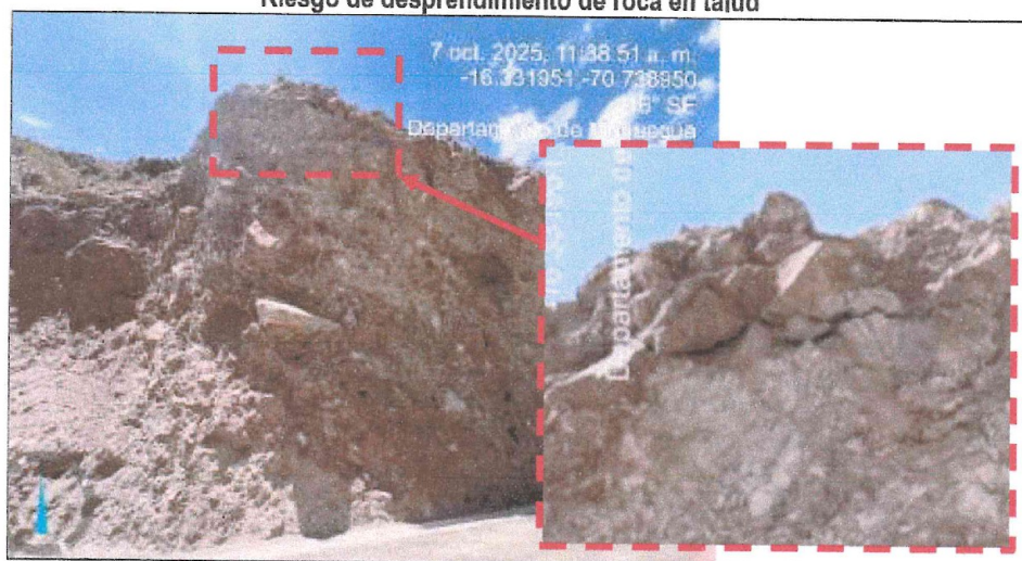
Imagen n.º 13 Riesgo de desprendimiento de roca en talud
