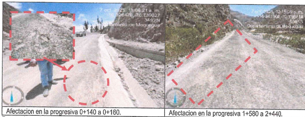
Afectación en la progresiva 0+140 a 0+160.
