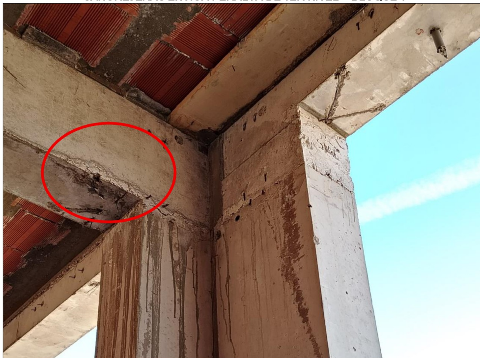
IMÁGEN N° 15 CANGREJERAS ENVIGA PERALTA DE 1ER NIVEL – BLOQUE 1
