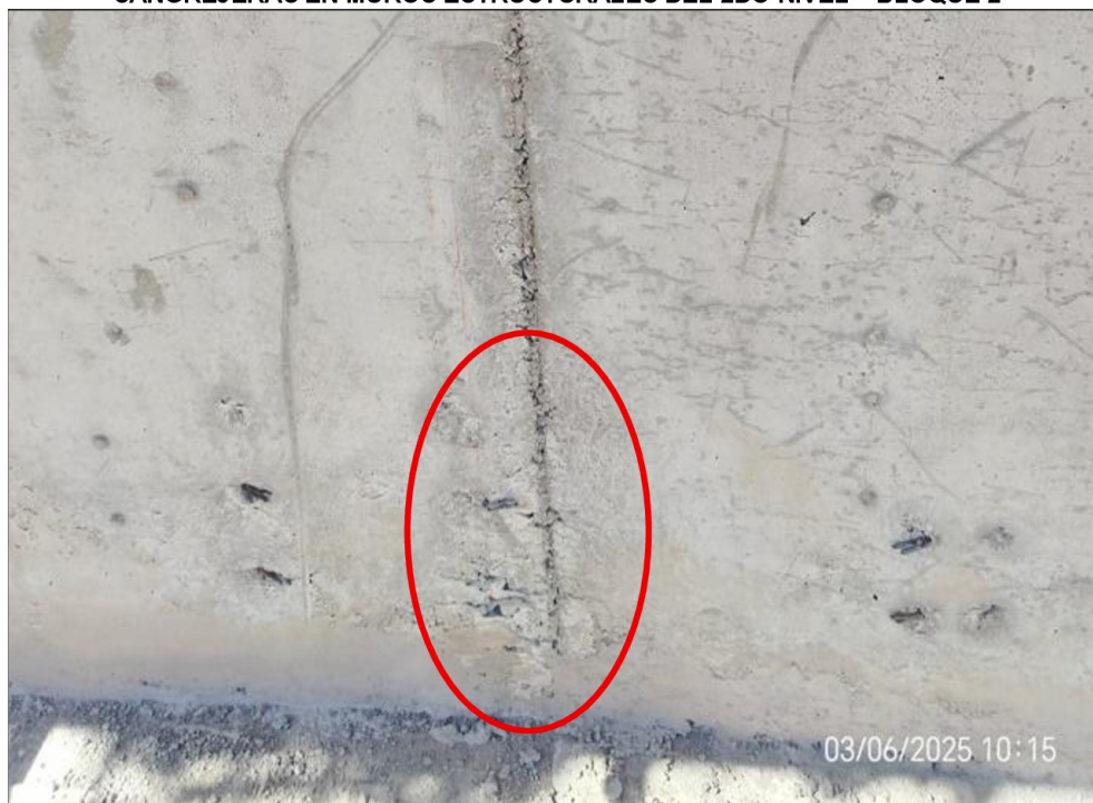
Cangrejas en muro estructural en el aula de innovación pedagógica.
