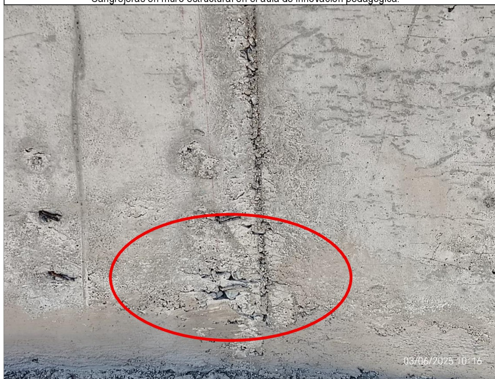
Cangrejas en muro estructural en el aula de innovación pedagógica.
