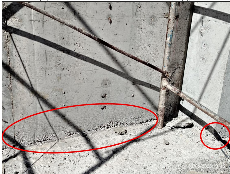
Cangrejas en muro estructural en deposito del aula de innovación pedagógica.
