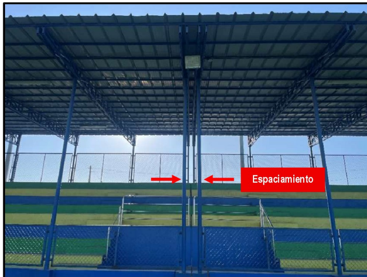
FOTOGRAFÍA N° 13 ALINEAMIENTO DE PARANTES VERTICALES
