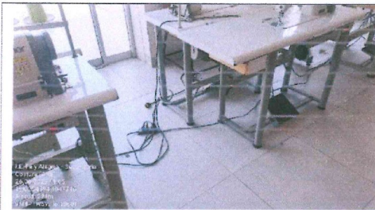
Imagen n.º 7 : Extensión eléctrica usada para funcionamiento de maquinas del taller de costura
