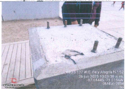
Imagen n.° 32: Rotura de varilla rosada.
