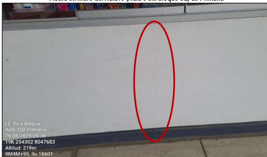
Imagen n.º 4 Fisura en muro del Aula10 (Aula 5 del bloque C2) de Primaria
