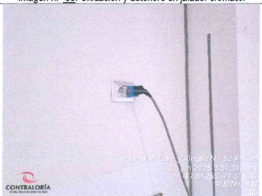
Imagen n.° 40: Conexión eléctrica sin contacto a tierra.
