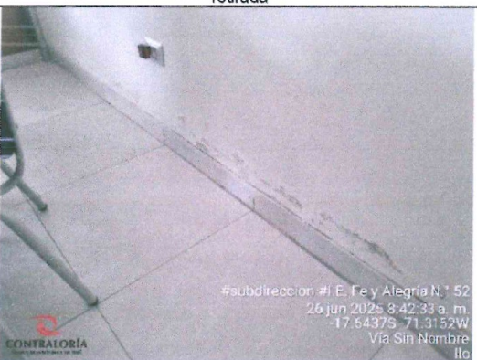
Imagen n.° 21: Eflorescencia debido a humedad en suelo de fundación.
