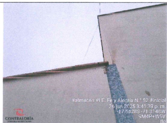
Imagen n.° 37: Fisura en enlucido adyacente a pastelero.
