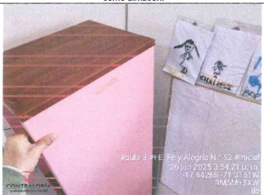
Imagen n.° 41: Mueble de melamina sin anclaje.
