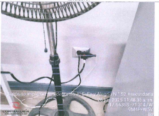
Imagen n.º 12 : Defectos en conexión eléctrica y sin contacto a tierra.
