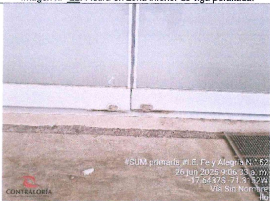
Imagen n.º 24: Puerta de vidrio templado desalineada.
