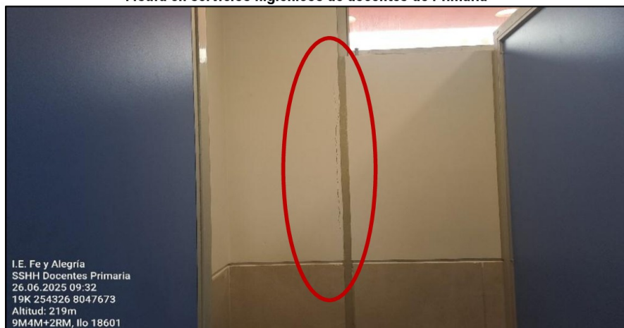
Imagen n.º 6 Fisura en servicios higiénicos de docentes de Primaria
