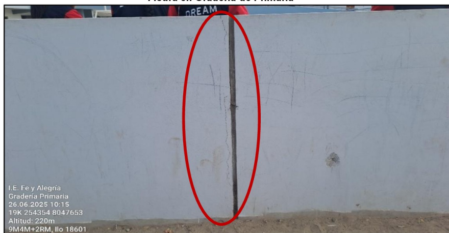
Imagen n.º 5 Fisura en Gradería de Primaria
