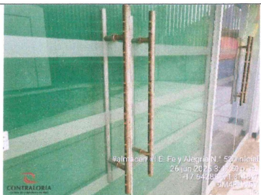
Imagen n.° 38: Oxidación y deterioro en jalador cromado.
