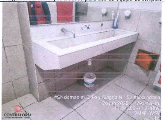
Imagen n.º 10 : Humedad y eflorescencia en zona cercana a lavadero.
