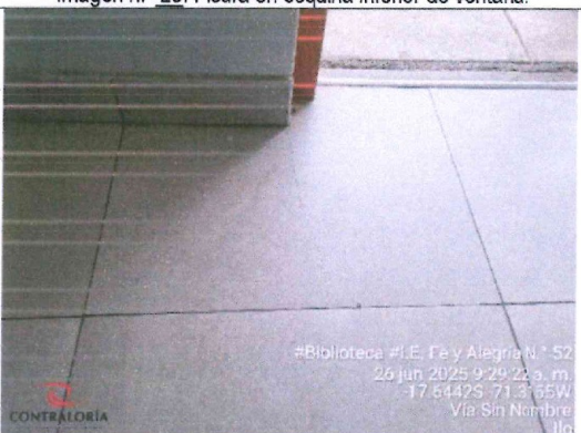
Imagen n.º 27: Fisura de pieza cerámica.
