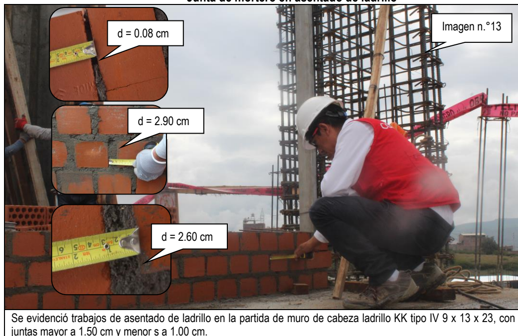
Junta de mortero en asentado de ladrillo
