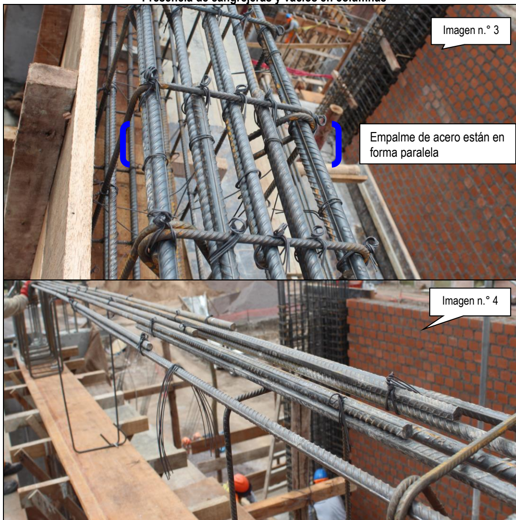
Imágenes n.ºs 3, 4 y 5 Presencia de cangrejeras y vacíos en columnas
