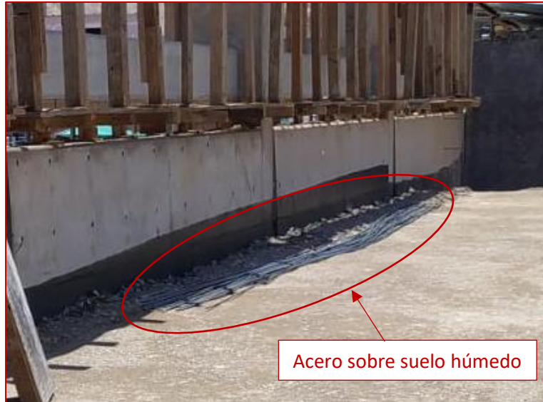
Imagen n.º 22 Acero en intemperie sobre suelo húmedo
