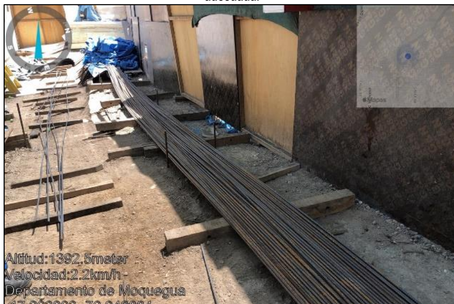
Imagen n.º 23 Acero con presencia de óxido por estar expuestas a la intemperie sin una cubierta adecuada.
