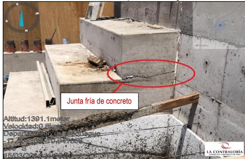
Imagen n.º 7 Junta fría entre los peldaños de la gradería
