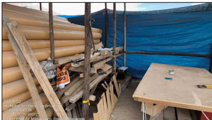
Imágenes n.ºs 24 y 25 Tuberías de alcantarillado sanitario almacenado a la intemperie y en contacto con el suelo
