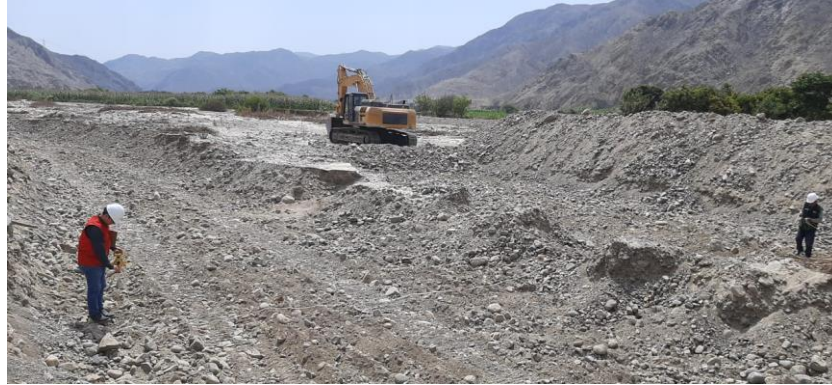
Imagen n.º 9 Ausencia del personal técnico y profesional - Santa Rosa 1
