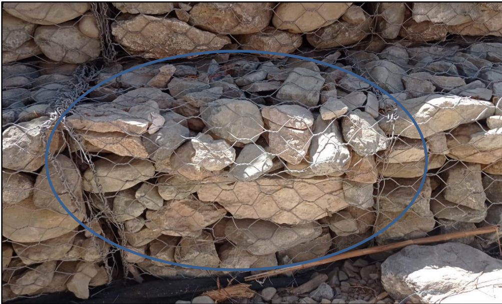
IMÁGEN N° 4 TEJIDO DE CAJAS DE GAVIONES DEFORMADA
