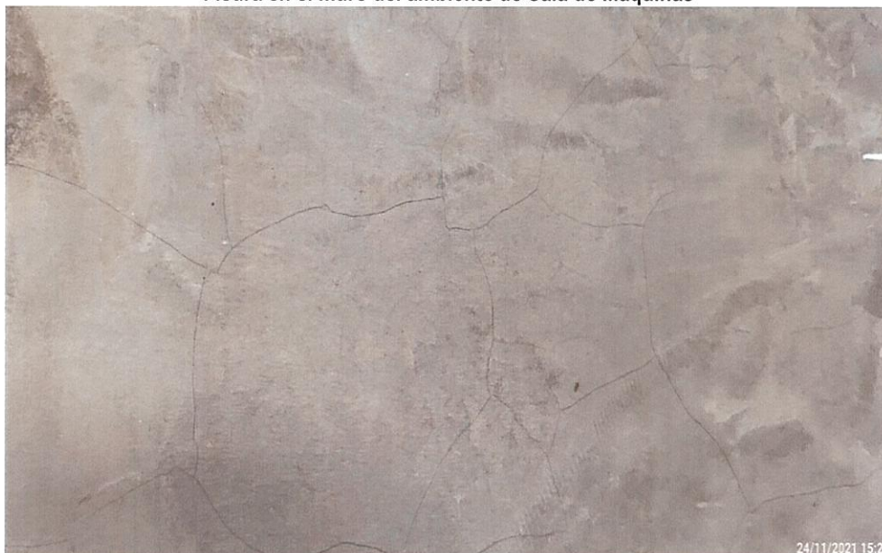
Toma Fotográfica n.º 6 Fisura en el muro del ambiente de Sala de Máquinas
